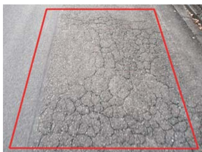
3D測量と同時にロードカメラが 路面のひび割れを撮影
